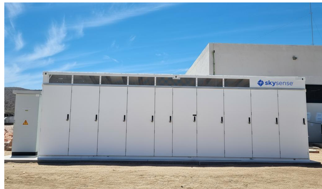
Figura 21. Fotografía del sistema BESS “Hotel en Los Cabos” Fuente: Skysense (2025).
