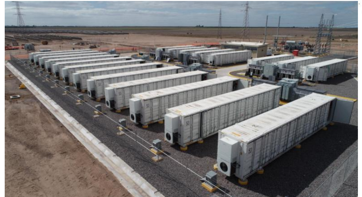
Figura 24. Fotografía del sistema BESS "La Toba" Fuente: Invenergy (2024).
